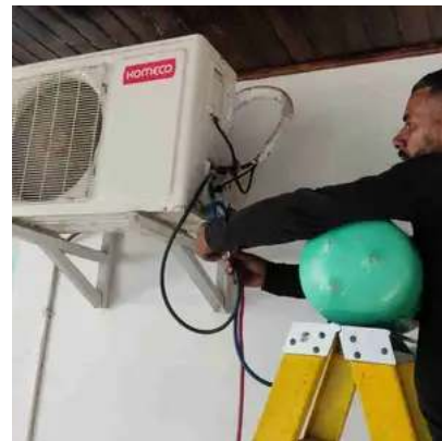
Carga de gas
