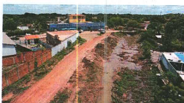
Foto 14-Trecho do canal a jusante com processo erosivo
