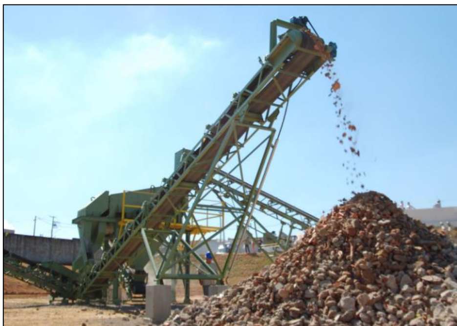
Figura 32 - Usina fixa de RCC.
