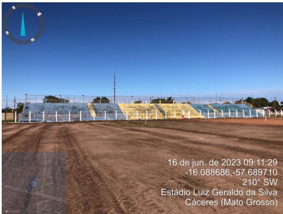
Foto 6 - Arquibancada A - Lixamento
