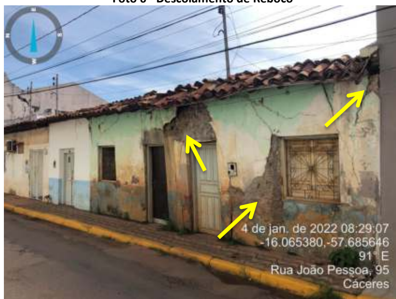
Foto 6 - Descolamento de Reboco
