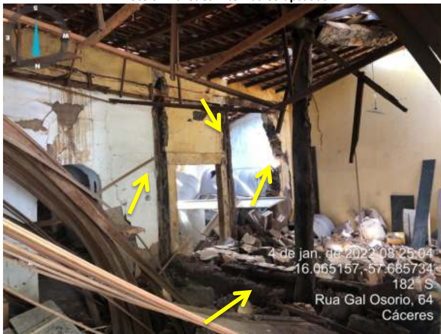
Foto 9 - Paredes Internas Colapsadas
