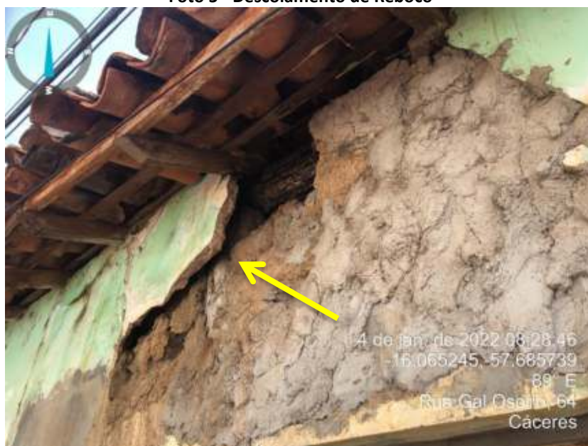
Foto 5 - Descolamento de Reboco
